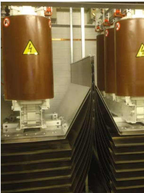
Inpandige transformatorruimte met afscherming
