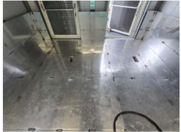
Afscherming transformatorruimte op dak ziekenhuis
