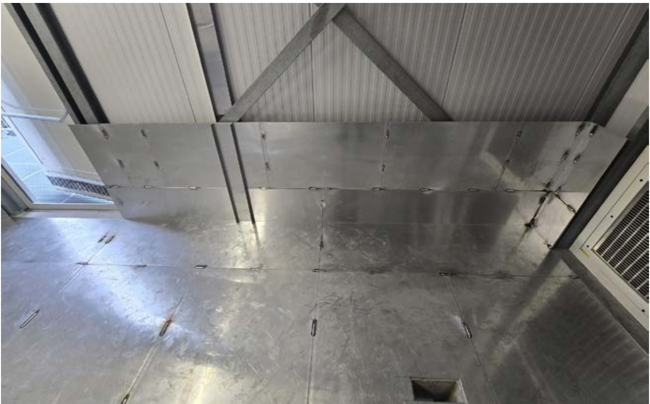
Afgeschermd vloer in transformatorruimte op het dak.
